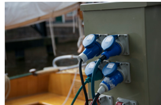
Oplaadpunt Elektrisch Varen
