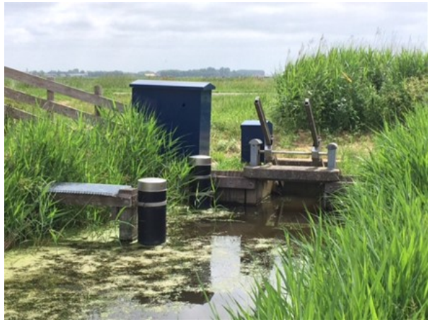
Automatische stuw en chloride meetpunt
