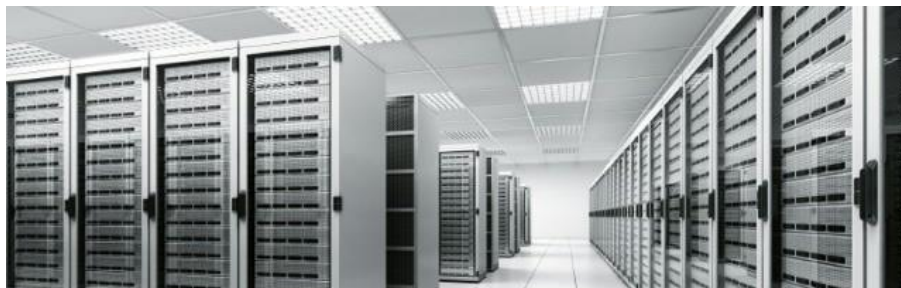
Figuur 17 - Datacentrum (een bron van lagetemperatuurwarmte)
