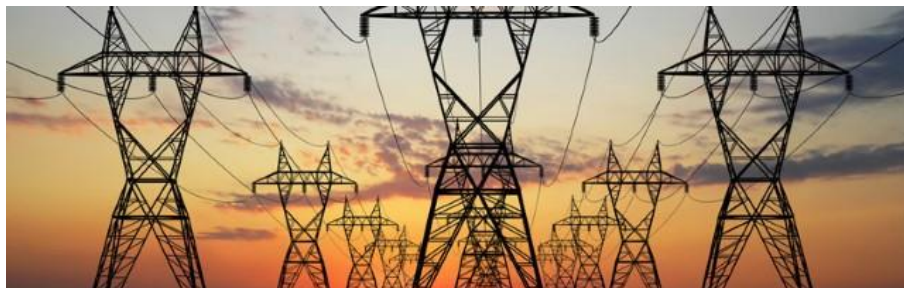
Figuur 11 - Hoogspanningsmasten t.b.v. het transport van elektriciteit
