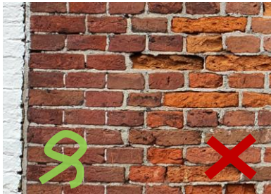
19 e eeuwse metselwerk met links een dunne gesneden voeg rechts inboetwerk met een zachte baksteen en harde cementspecievoeg.
