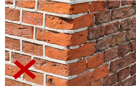
18 e eeuwse metselwerk waar recent een nieuwe snijvoeg in is gezet: de baksteen is beschadigd en aan de zijkant is de oorspronkelijke dunne voeg nog te zien.
